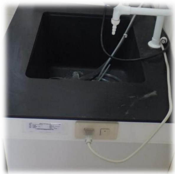
未設漏電斷路器
