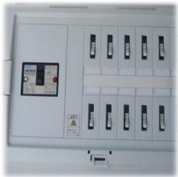
中隔板、分路標示
