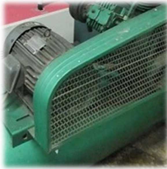
空壓機傳動裝置
