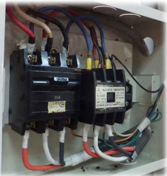
開關箱未設中隔板
