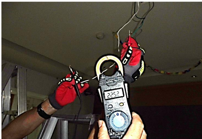
▲照片1： 該照明設備之手捺開關閉後，照明設備其中1條電源線路仍有帶電225V。
