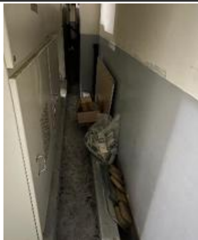
▲電氣機房內堆放無關之物品
