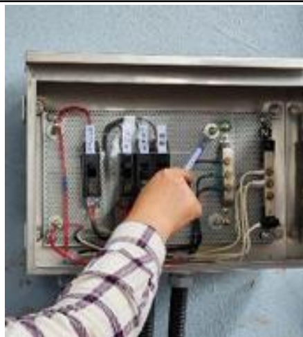
▲電氣開關箱之金屬帶電部分未確實防護
