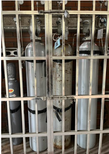
▲圖2 高壓氣體鋼瓶固定
