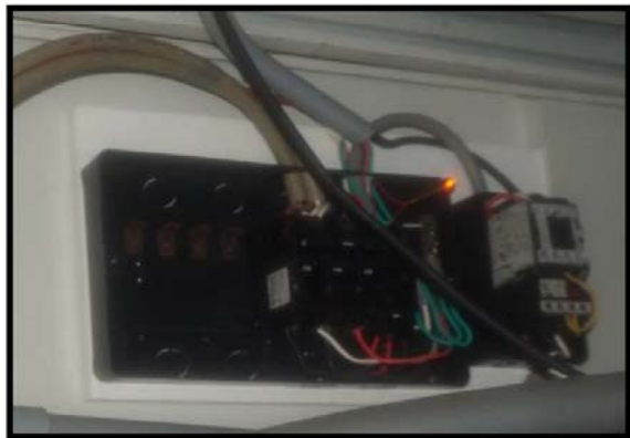
不安全的裸露電源開關
