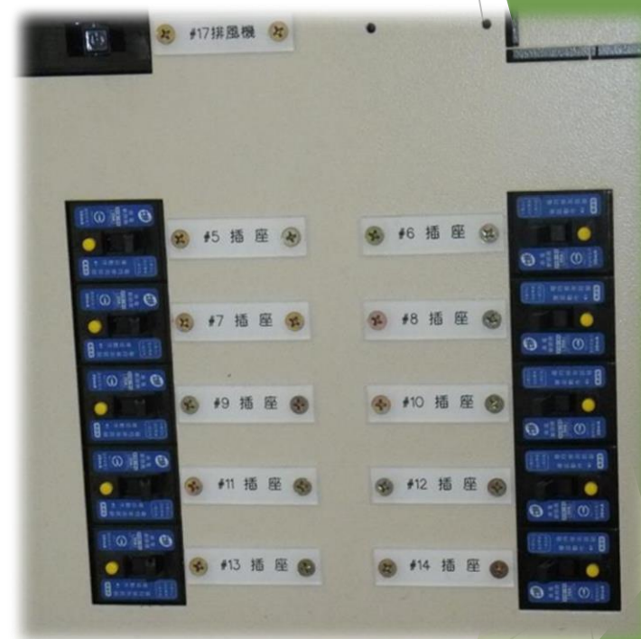
分路設置漏電斷路器
