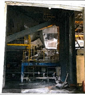
爐渣清除設備
